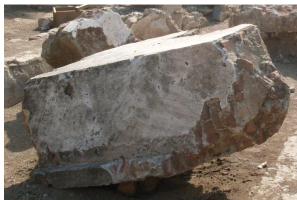
Ilustración 30 Detalle de muro colapsado, se observa el ladrillo y el estuco aplicado.
