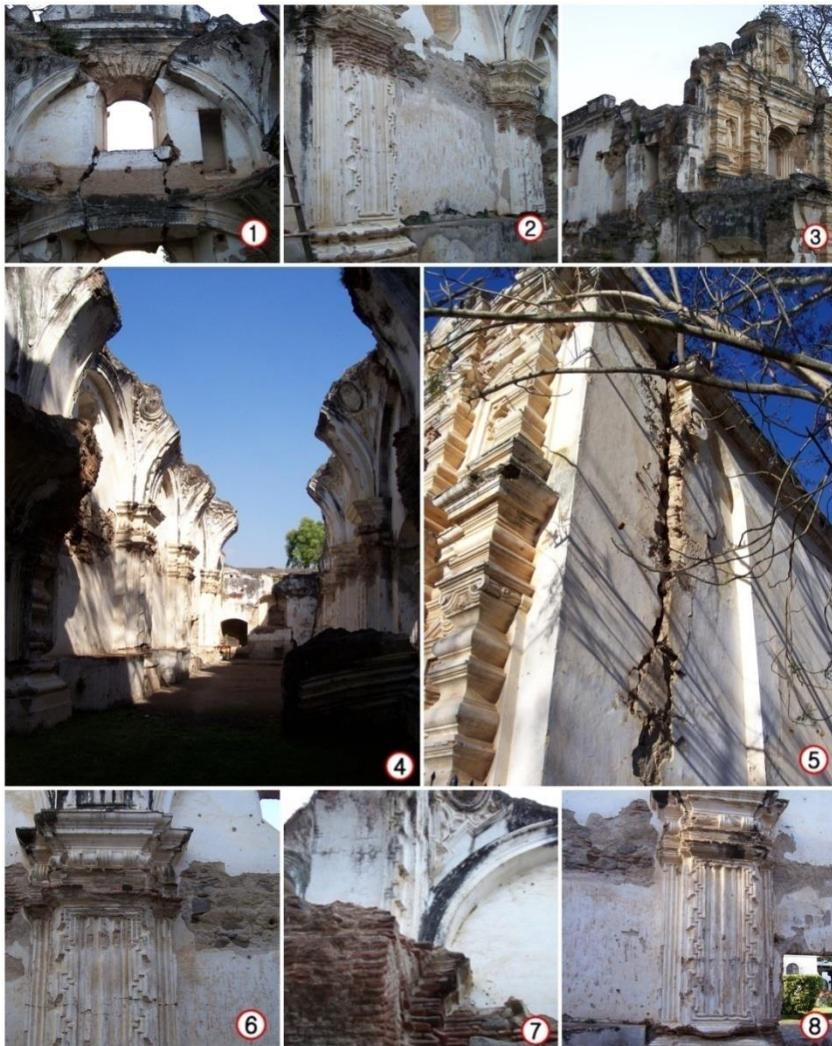
1) Grietas importantes en la fachada 2) Grietas en los muros longitudinales 3) Colapso del campanario 4) Colapso de la totalidad de la cubierta 5) Grietas por corte en el muro sur 6) Grietas al nivel anterior del ripio 7) Colapso del coro 8) Faltante de acabados en los muros
