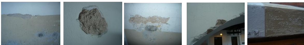
Evidencia de los problemas de humedad y la pérdida de material.
