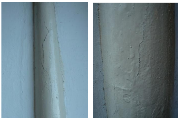
Detalle de las fisuras y cáncer en los apoyos de hierro.
