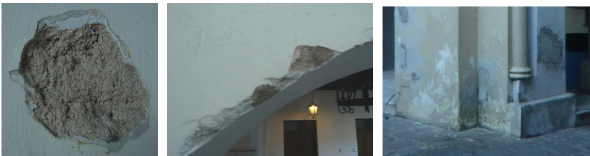
Detalle de desprendimientos de acabados en los muros, área de acceso principal.
