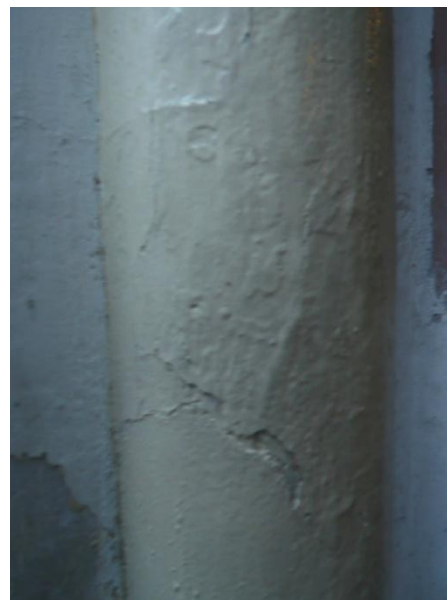
Grietas y pérdida de sección en apoyos metálicos.
