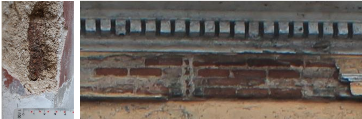
Detalle de las características de los ladrillos utilizados en los muros de “La Casona”.
