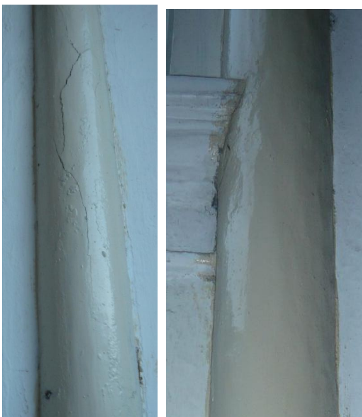
Detalles de los deterioros en los apoyos metálicos, sobre todo en los empotrados en los muros. Nótese los problemas de fisuras o hinchamientos por corrosión interna.
