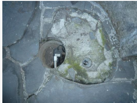
Detalle del piso de la fuente y el sistema eléctrico para su funcionamiento.
