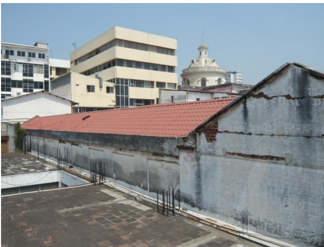
Detalle del muro lindero Sur del edificio “La Casona” y la loza del edificio Santa Cruz. Nótese la diferencia entre el muro de ladrillo y el concreto armado en la unión de ambos muros. Fuente: J. Cáceres, 2013.
