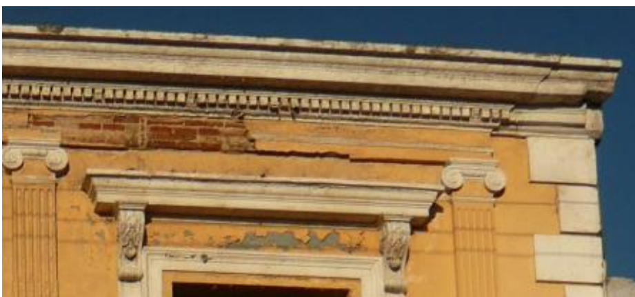
Detalle de los desprendimientos de molduras y cornisas.
