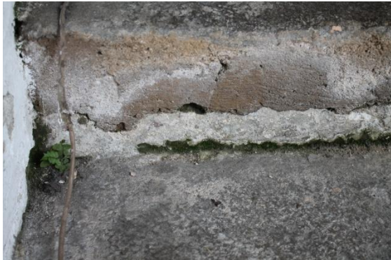
Detalle de piedras que constituyen las gradas. Nótese sus reparaciones con cemento, las grietas, los poros y el afloramiento de plantas y líquenes.
