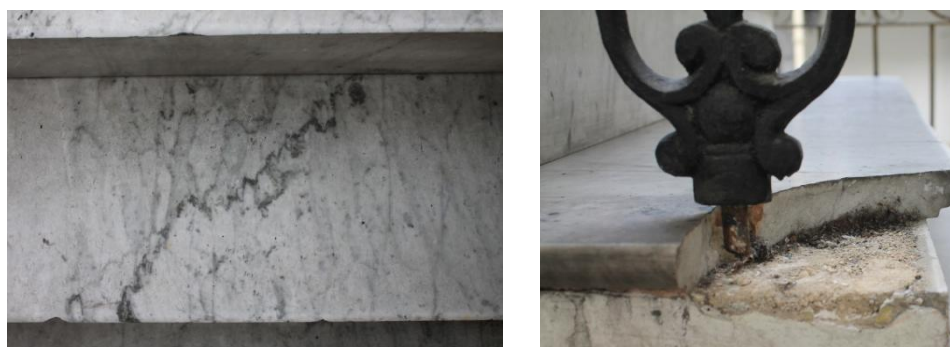
Detalle de las vetas del mármol dispuesto sobre las huellas de las gradas y el empotrado con los pasamanos de hierro. Nótese la oxidación del hierro en el área de empotramiento.
