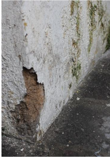
Detalle de la humedad y el desconchamiento de los acabados finales.
