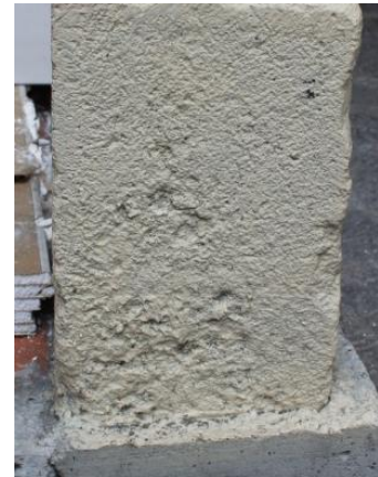
Detalle de la porosidad de la piedra en las bases para apoyos metálicos.
