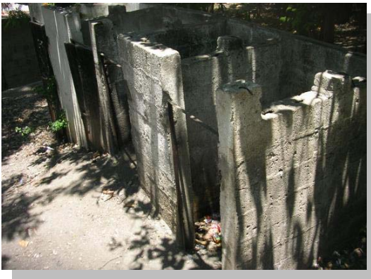
Imagen 5. Existen algunas instalaciones que por falta de inversión se han deteriorado.
