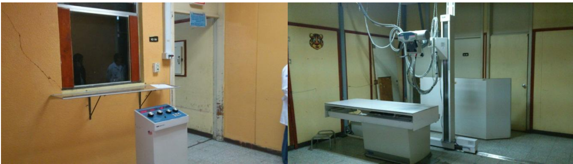
Fotografía 5 Fuente: Galería Propia, Sala De Rayos X 2.
