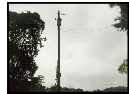
FOTO: POSTE DE LUZ, TRANSFORMADOR
