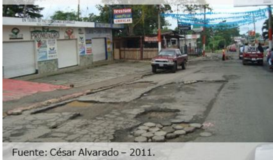
Imagen No. 32 – Carpeta asfáltica en muy malas condiciones, con reparación provisional inadecuada.
