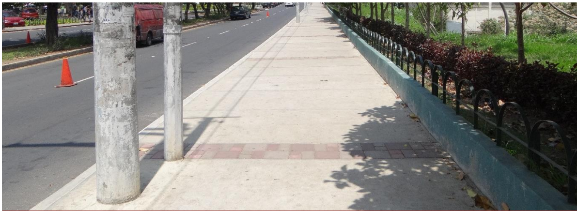
Imagén de la situación actual de las aceras reconstruidas posterior al recapeo
