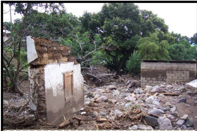
IMAGEN #2: Vivienda afectada por tormenta Stan año 2005, Piedra Grande, San Pedro Sac. San Marcos. Fuente propia
