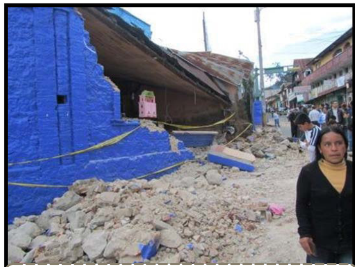
IMAGEN #7: Vivienda afectada por terremoto de 07/10/12, San Marcos.
