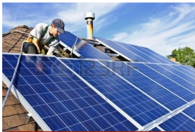
Instalación de paneles solares en vivienda, https://es.123rf.com/photo_5019896_panel-solar.html // (10 de marzo de 2014).
