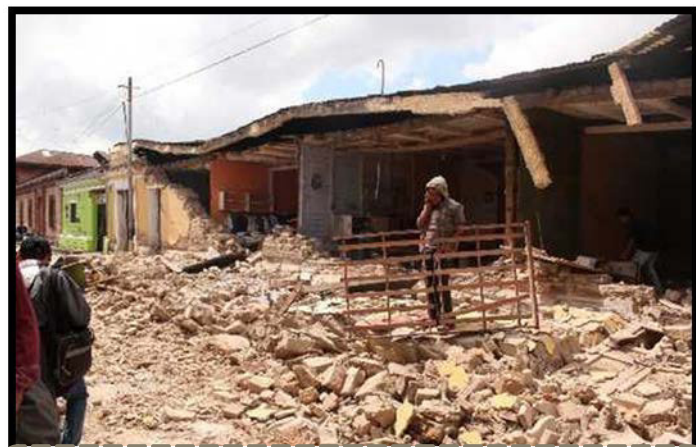
IMAGEN #4: Viviendas damnificadas durante el terremoto del 7 de noviembre de 2012 en San Marcos. Fuente propia
