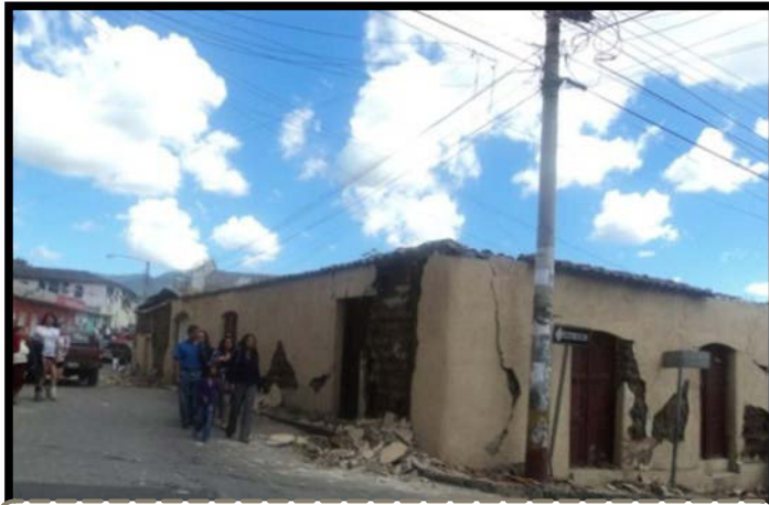
IMAGEN #6: Vivienda afectada por terremoto de 07/10/12, San Marcos.
