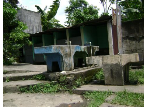
Los servicios sanitarios están en la parte posterior del establecimiento. No todos cuentan con puerta
