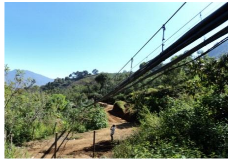
FOT. 31 Vista instalación agua entubada, La Libertad, Huehuetenango. Fuente: Elaboración propia
