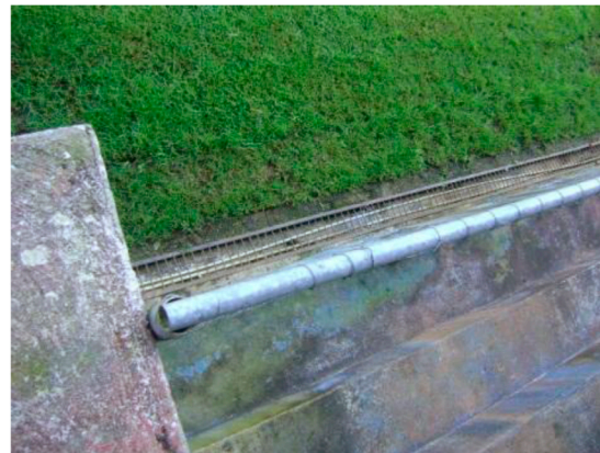
FOT. 45 Vista sistema de riego de agua potable en terreno de proyecto. Fuente: Elaboración propia
