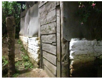
Figura 51. Fotografía de exterior de cocina.
