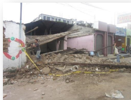
Fotografía.4 Terremoto 7 de Noviembre, San Marcos, Fuente Autor. Diciembre de 2013
