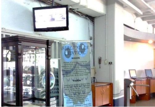
Fotografía No.72 Cámaras de Seguridad. Fuente: Fotografía Toma Propia
