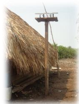
INFORMACIÓN DE CAMPO: Poste y Base del panel de energía solar. FOTO 2 : Cotóm, C.
