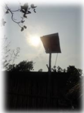
INFORMACIÓN DE CAMPO: Panel en plena captación de energía solar. FOTO 3: Cotóm, C.
