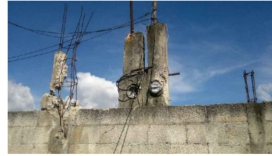
FOTO 4: ACOMETIDA DE ELECTRICIDAD LA CUAL ES PROVISTA POR LA EMPRESA EGGSA.
