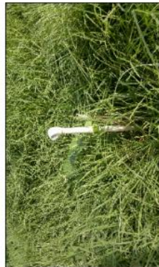
FOTO 2: TOMA DE AGUA DEL TERRENO LA CUAL ES PROPORCIONADA POR LA RESIDENCIAL LINDA VISTA MEDIANTE UN POZO PROPIO DE DICHA RESIDENCIAL POR LA QUE SE PAGA UNA CUOTA MENSUAL.
