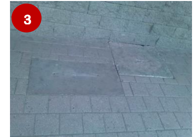
Acometida de agua potable
