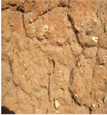
Suelo erosionado y dañado por lluvias en la época de mayo a octubre Junio 2,012 Fuente de elaboración propia
