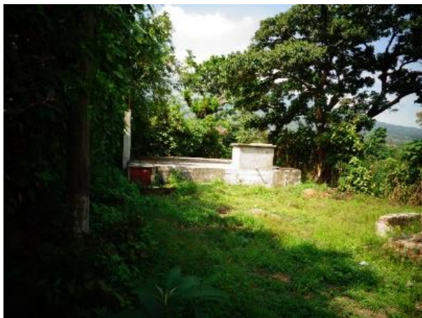
Ilustración 24: vista del tanque de captación de agua potable de la Aldea, de la cual es abastecida por el nacimiento de la montaña del Cucurucho.
