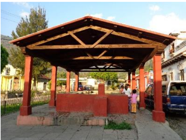
Ilustración 21: Estado Actual del lavadero o pila pública, construida en 1958 por las obras de la Municipalidad local.
