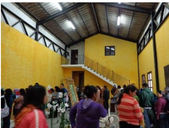
Ilustración 6: esta vista interna es del Salón de Usos Múltiples , en la cual desarrollan actividades sociales y además de exposiciones, es un edificio construido dentro del área de la plaza, además crea alteraciones y deterioro exteriores y en su interior no hay un ambiente agradable, con estructuras vistas y sin estética. Foto Jorge Sarg; 2014
