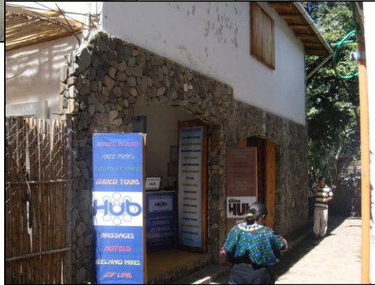
FOTOGRAFIA No.22 Fachaleta con piedra bola, muros de block, entrepiso fundido, acabados en madera, cubierta de madera y lámina. Tomada por: Diana Carolina Muñoz.
