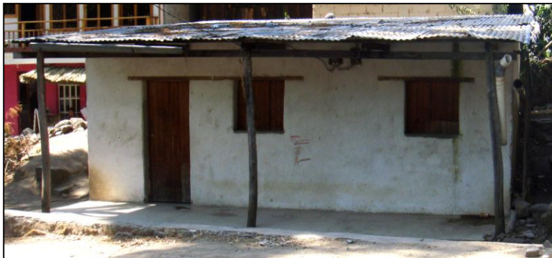
FOTOGRAFIAS No.19 Construcción de adobe con repello. Tomada por: Diana Carolina Muñoz.
