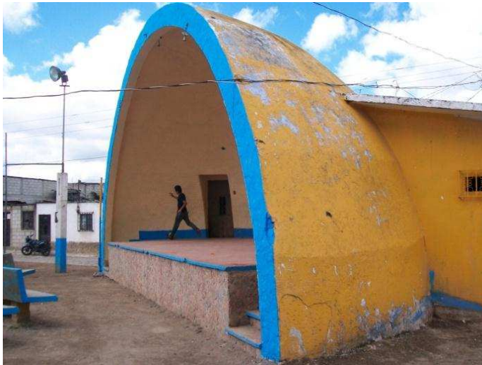
DETERIORO DE LA CONCHA ACÚSTICA DE EL TEJAR CHIMALTENANGO
