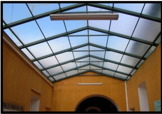
FOTOGRAFÍA 11/ Integración de techo de vidrios láminas de asbesto
