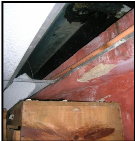
FOTOGRAFÍA 37/ deterioros en el canal techo dañado
