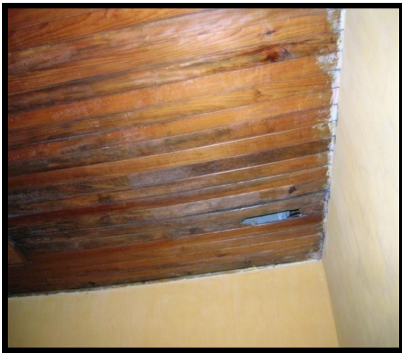
FOTOGRAFÍA /14 machihembre en mal estado por humedad de la Dirección General del Patrimonio Cultural y Natural
