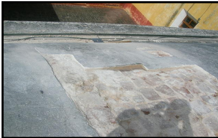
FOTOGRAFÍA 19 ver descripción de los deterioros de la bóveda de
