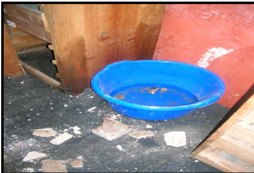
FOTOGRAFÍA 38/ Goteras por filtración por
