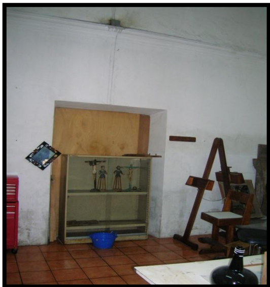
FOTOGRAFÍA 25/ Oficina con daños de inundación por base de cal y color Filtración por las ventanas
