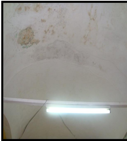
FOTOGRAFÍA No. 51 Se observa desprendimiento del de repello a base de cal por humedad en la bóveda
