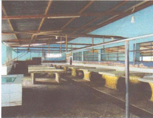
Vista interna del área de rastro de ganado menor, como se observa las áreas no están definidas ni cuenta con el respectivo proceso de destace y despiece que recomienda el Ministerio de Agricultura, Ganadería y alimentación, así como la FAO. Fuente: Investigación propia.
