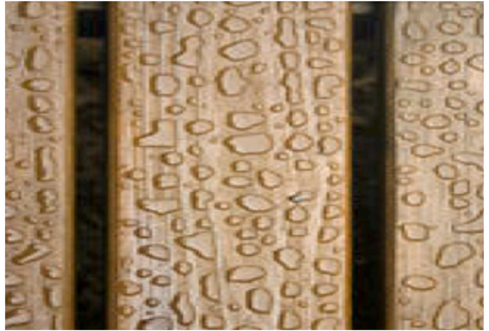
Imagen 35: El agua y la humedad aunque no atacan directamente a la madera, favorecen las condiciones para el desarrollo de hongos y los insectos.
