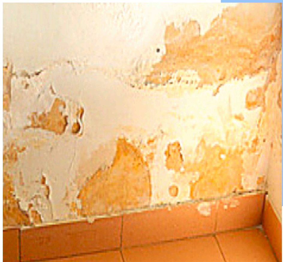
Imagen 19: Pared deteriorada por humedad, sin recubrimiento adecuado
