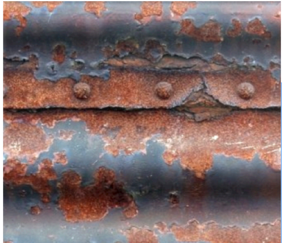
Imagen 18: Superficie oxidada, sin recubrimiento adecuado
