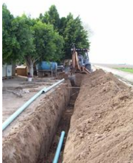
Fotografía 24. Sistema de drenajes en Zona 2. (2013). Fuente propia.
