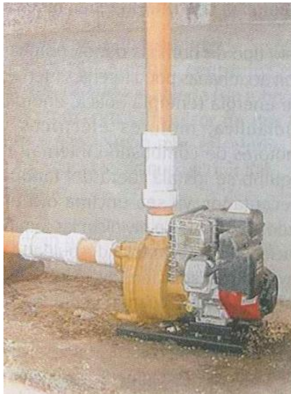
BOMBA PARA LAVADO POR GRAVEDAD (FOTO 19) (Imagen cortesía de Anacafé)
