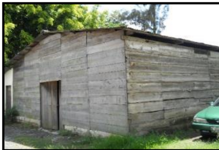
2. Bodega de madera en mal estado.
