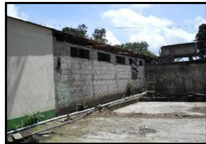
3. Tanque de agua potable. Acabados incompletos.
