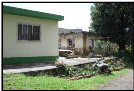
1. Instalaciones abandonadas, mala imagen Institucional.
