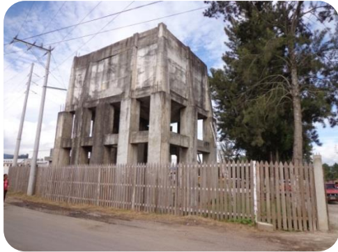
Al Oeste del terreno existe un tanque cisterna elevado que actualmente está en desuso y en estado de deterioro. IMAGEN NO. 9 - Foto Propia
