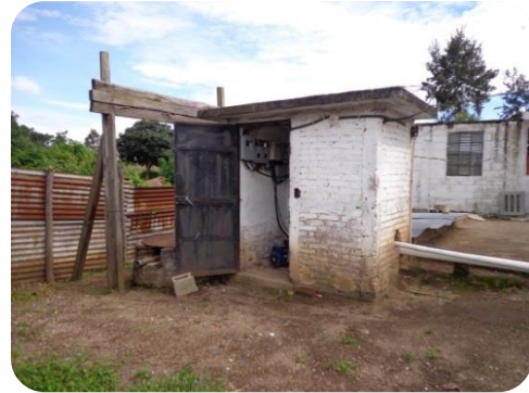
A un costado de la bodega se ubica el pozo de agua y su cuarto de máquinas, que es utilizado para distribuirla a los cantones cercanos.
