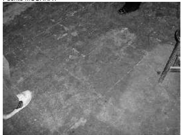
Pisos en mal estado en todas las áreas Fotografía LR
