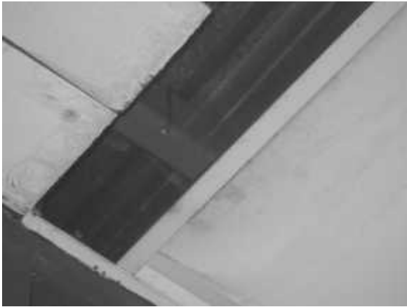
Filtración de humedad en techo.
