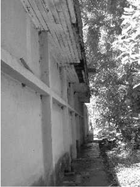
Deterioro por humedad, microflora.
