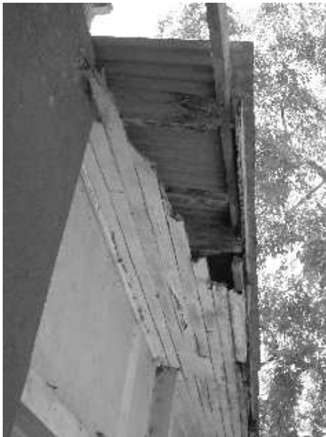
Deterioro del techo y machimbre.
