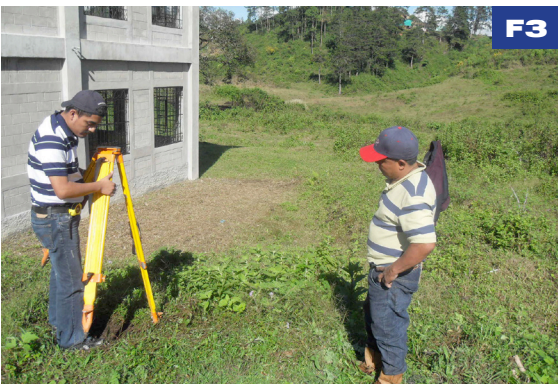
Colocando el teodolito para iniciar la medición del terreno. Al fondo vegetación de coníferas.
