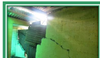
FOTO 28 VIVIENDA AFECTADA POR SISMO 7/11/13, LA LOMA SECTOR 2, SAN MARTIN SACATEPEQUEZ FUENTE: ALONDRA GUZMAN FECHA: 11/7/2014
