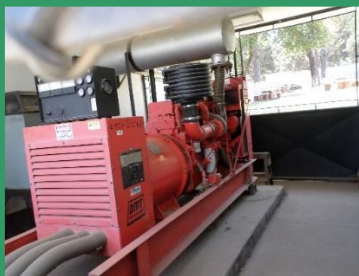
FOTO 17 GENERADOR ELECTRICO INTECAP QUETZALTENANGO FUENTE: ALONDRA GUZMAN FECHA: 20/4/2015
