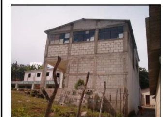
FOTOGRAFIA 4 EL TERRENO DONDE SE ENCUENTRA ASENTADA LA ESCUELA ES DE TOPOGRAFIA IRREGULAR, SE HAN HECHO TRABAJOS PARA FORMAR EL TALUD, LA PENDIENTE PROMEDIO ES DEL 22%.
