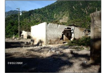
FOTOGRAFIA 4 ESTA FOTOGRAFÍA SE TOMÓ HACIA EL COSTADO DE LA IGLESIA. SE PUEDEN OBSERVAR LOS DAÑOS OCASIONADOS EN LOS MUROS, LA TOPOGRAFÍA DEL LUGAR FUE MODIFICADA.
