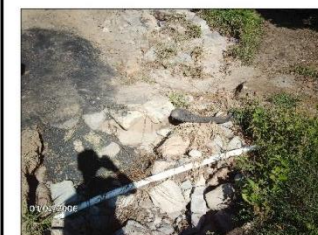
FOTOGRAFIA 3 EN ALGUNOS PUNTOS DEL CAMINO LA TUBERÍA DE AGUA QUEDÓ EXPUESTA DEBIDO A LA EROSIÓN CAUSADA POR LA CORRIENTE DE AGUA
