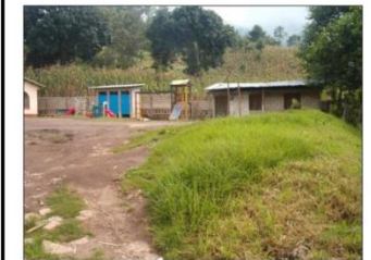
FOTOGRAFIA 3 EN ESTA FOTO SE OBSERVA QUE LA PENDIENTE DE ESTE LADO DE LA MONTAÑA SE DIRIGE TOTALMENTE HACIA EL ÁREA DE BAÑOS, PARA EVITAR LOS FLUJOS DE AGUA DE LLUVIA SE CONSTRUYÓ UN MURO DE PIEDRA Y BLOCK EN ESTE TRAMO DEL PREDIO.
