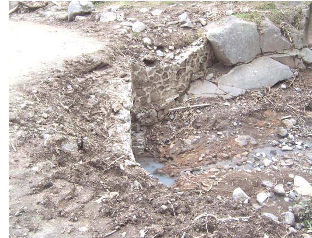
Foto #28 Puente destruido. Fuente: Informe de la situación ante el desastre del 5 octubre 2,005 elaborado por la Municipalidad de San Juan La Laguna.
