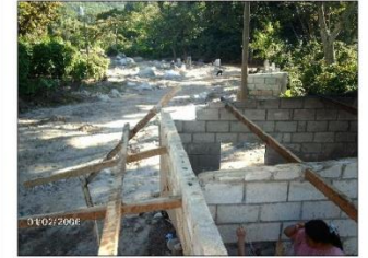
FOTOGRAFIA 2 ESTA VIVIENDA ESTÁ A LA PAR DE LA ANTERIOR PERO PRESENTA DAÑOS MAYORES DEBIDO A SU POSICIÓN RESPECTO A LA DIRECCIÓN DEL RÍO.
