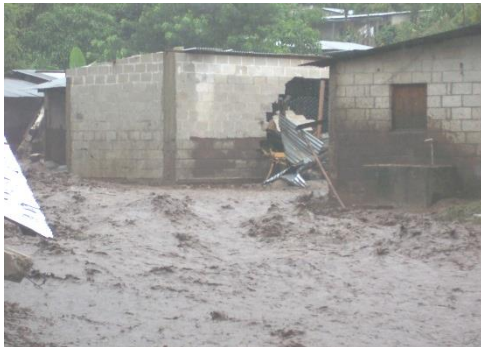
Foto #13 El flujo de lodo, árboles y rocas provocó daños graves a las viviendas Fuente: Informe de la situación ante el desastre del 5 octubre 2,005 elaborado por la Municipalidad de San Juan La Laguna
