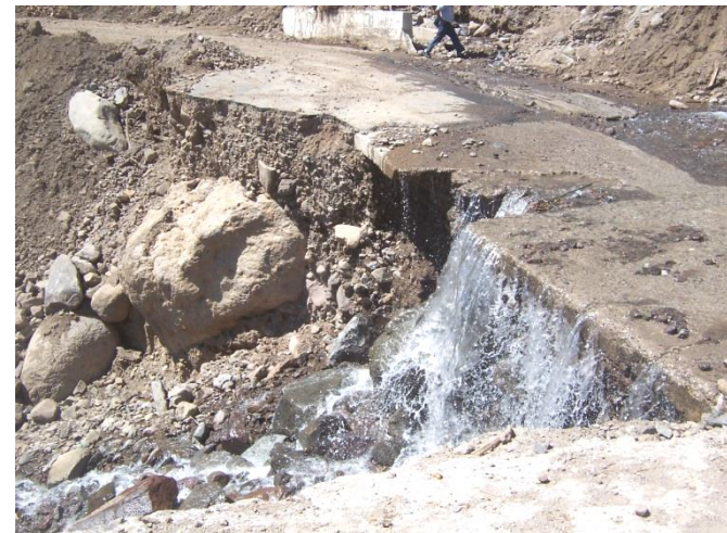
Foto #26 Vía de acceso por San Pablo La Laguna, completamente destruida. Fuente: Informe de la situación ante el desastre del 5 octubre 2, 005 elaborado por la Municipalidad de San Juan La Laguna.
