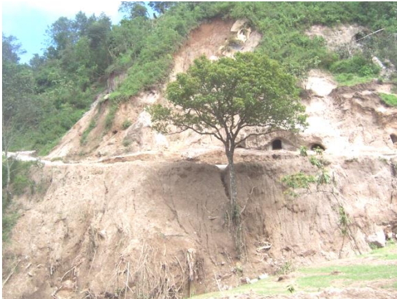
Foto #27 Carretera de terracería destruida. Fuente: Informe de la situación ante el desastre del 5 octubre 2,005 elaborado por la Municipalidad de San Juan La Laguna.
