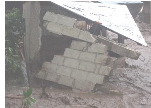
Foto #14 Viviendas destruidas completamente por la corriente en el barrio 5 de Enero. Fuente: Informe de la situación ante el desastre del 5 octubre 2,005 elaborado por la Municipalidad de San Juan La Laguna
