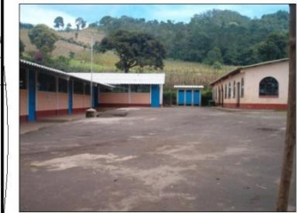
FOTOGRAFIA 2 PARTE DEL AGUA DE LLUVIA QUE CAE SOBRE LA MONTAÑA CORRE EN DIRECCIÓN DE LA ESCUELA. EXISTE UN TALUD DE TIERRA EN LA PARTE TRASERA DE LA ESCUELA QUE SE HA DERRUMBADO EN ALGUNAS PARTES DEBIDO A LA SATURACIÓN DE HUMEDAD.
