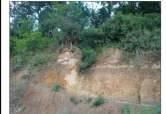
FOTOGRAFIA 2 ESTA FOTOGRAFÍA SE TOMÓ EN LA PARTE BAJA DE LA MONTAÑA DONDE PASA EL CAMINO DE TIERRA, ESTE TIPO DE DERRUMBES SE OBSERVAN A LO LARGO DEL CAMINO.
