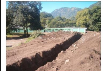
FOTOGRAFIA 3 SE CONSTRUYE UN MURO DE PIEDRA PARA PROTEGER LA ESCUELA DE OTRA INUNDACION DE LODO
