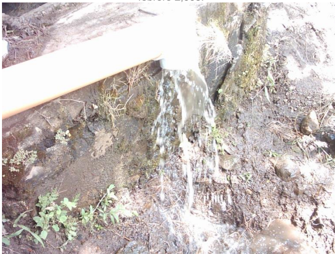
Foto #25 Tuberías principales de agua dañadas por los deslaves. Fuente: Informe de la situación ante el desastre del 5 octubre 2, 005 elaborado por la Municipalidad de San Juan La Laguna.
