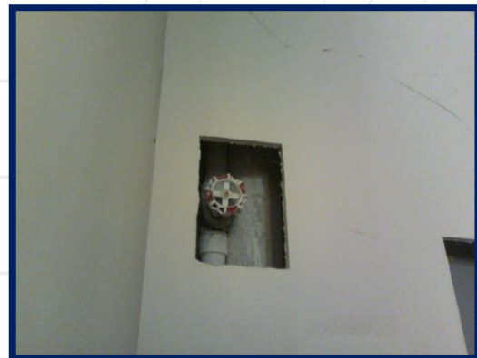
LLAVE DE PASO PARA CONTROL DE AGUA Fotografía No. 36 Fuente: Alejandro Gaytán S.
