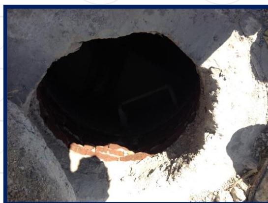
RECOLECTOR DRENAJES MONJAS, JALAPA. Fotografía 50 Fuente: Alejandro Gaytán S.
