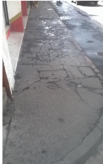
Figura 65 Banqueta con grietas y bordillo roto, 7ª calle de 3ª a 4ª avenida. Fotografía propia (Amatitlán 2015)
