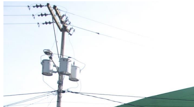
Figura 110 Poste de concreto con luminaria y 3 transformadores, ubicado frente a un supermercado, en la 6ª calle de 2ª a 3ª Avenida. Fotografía propia (Amatlán 2015)
