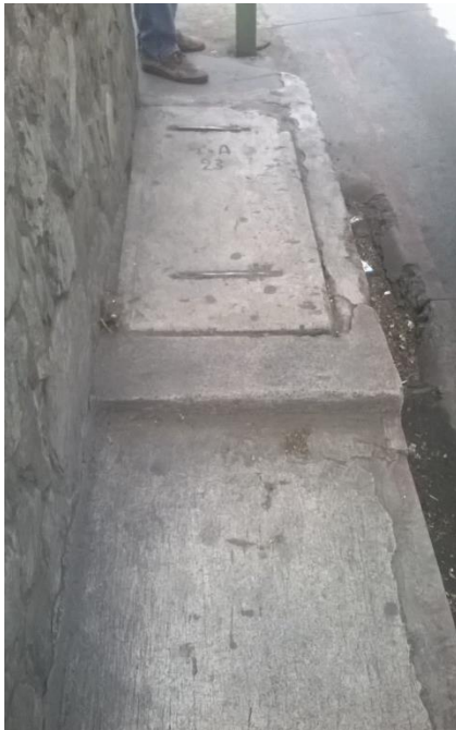
Figura 101 Caja tragante, la cual genera una grada en el área de acera, esquina de la 2ª Avenida de 8ª calle. Fotografía propia (Amatitlán 2015)
