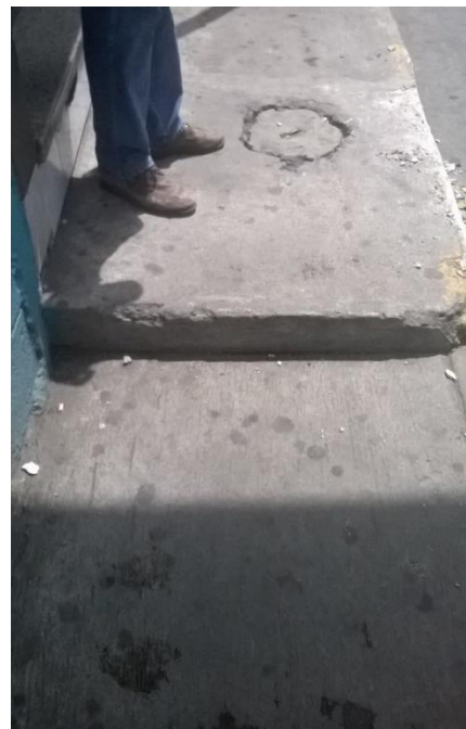
Figura 69 Falta de uniformidad de niveles de banqueta, 2ª avenida de 7ª a 8ª calle. Fotografía propia (Amatitlán 2015)
