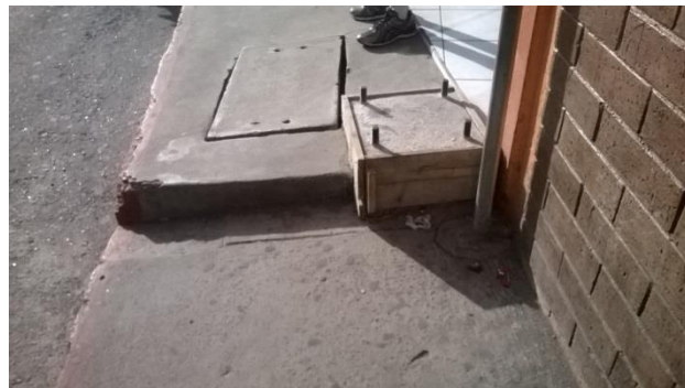
Figura 117 Construcción de base para cabina telefónica junto a caja telefónica tipo subterránea, a la cual se colocó una plancha de concreto que no se ajusta correctamente, ubicada en la 7ª calle de 3ª a 4ª Avenida. Fotografía propia (Amatitlán 2015)
