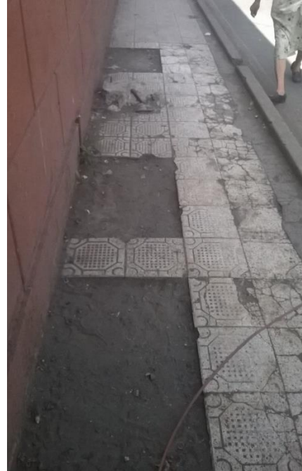
Figura 67 Banqueta deteriorada con faltantes de loseta y bordillo roto, 2ª avenida de 7ª a 8ª calle. Fotografía propia (Amatitlán 2015)
