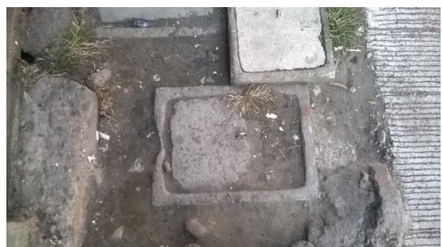
Figura 95 Tapadera de caja con deterioros, 3ª Avenida de 7ª a 8ª calle. Fotografía propia (Amatitlán 2015)
