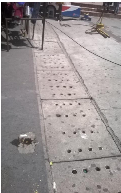
Figura 103 Tragante con tapadera de concreto perforada ubicada a lo ancho de la 2ª Avenida en la intersección de la 7ª calle. Fotografía propia (Amatitlán 2015)
