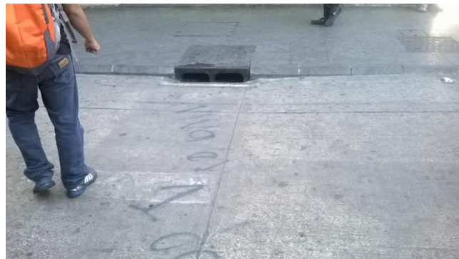
Figura 12 Ubicación de caja tipo tragante. Fotografía propia (Paseo de la Sexta, Guatemala, 2015)
