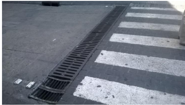
Figura 11 Ubicación de rejilla de drenaje a lo ancho de la vía vehicular. Fotografía propia (Paseo de la Sexta, Guatemala, 2015)
