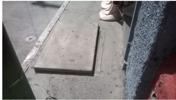
Figura 116 Caja telefónica tipo subterránea, la tapadera metálica fue sustraída y se colocó un plancha de concreto que genera un obstáculo al transitar por la banqueta ubicada en la 6ª calle de 3ª a 4ª Avenida. Fotografía propia (Amatitlán 2015)
