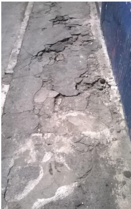
Figura 64 Banqueta con grietas y baches, 6ª calle de 3ª a 4ª avenida. Fotografía propia (Amatitlán 2015)
