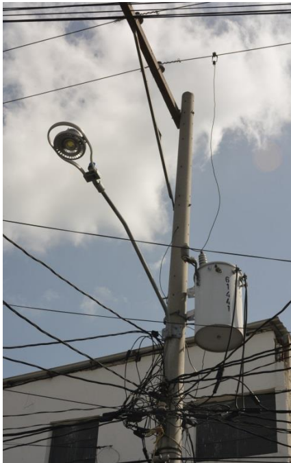
Figura 105 Poste de concreto con luminaria, también se observa la aglomeración de líneas eléctricas, esquina 4ª Avenida y 7ª calle. Fotografía propia (Amatitlán 2015)
