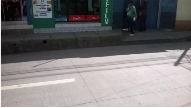
Figura 70 Falta de uniformidad de niveles en banqueta, 6ª calle de 3ª a 4ª calle. Fotografía propia (Amatlán 2015)
