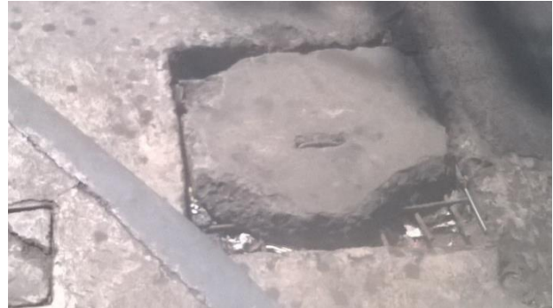
Figura 98 Tapadera con alto deterioro, 7ª calle de 3ª a 4ª Avenida. Fotografía propia (Amatitlán 2015)
