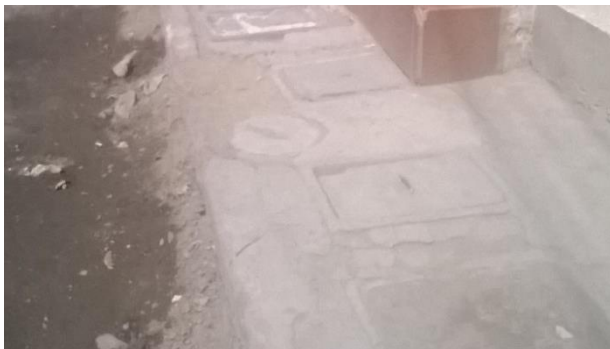
Figura 94 Aglomeración de cajas de agua debido a la ubicación de locales comerciales, 3ª Avenida de 7ª a 8ª calle. Fotografía propia (Amatitlán 2015)
