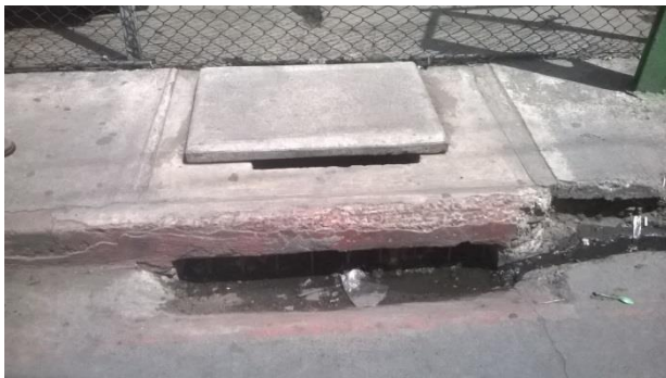
Figura 99 Caja de tragante sin tapadera, se colocó un plancha de concreto que no corresponde en dimensiones, 3ª Avenida de 7ª a 8ª calle. Fotografía propia (Amatitlán 2015)
