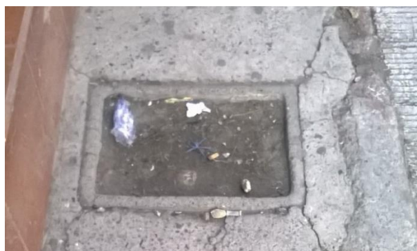
Figura 96 Tapadera de caja con deterioros, 3ª Avenida de 7ª a 8ª calle. Fotografía propia (Amatitlán 2015)
