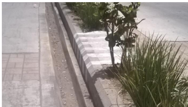
Figura 82 Área de paso peatonal sin condiciones adecuadas sobre arriate en calle de doble vía, 3ª avenida de 7ª a 8ª acalle. Fotografía propia (Amatitlán 2015)
