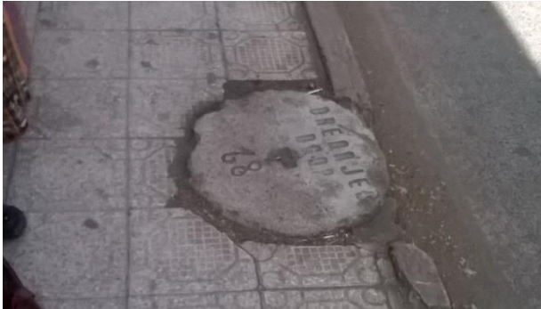
Figura 97 Tapadera de caja con deterioros, 3ª Avenida de 7ª a 8ª calle. Fotografía propia (Amatitlán 2015)
