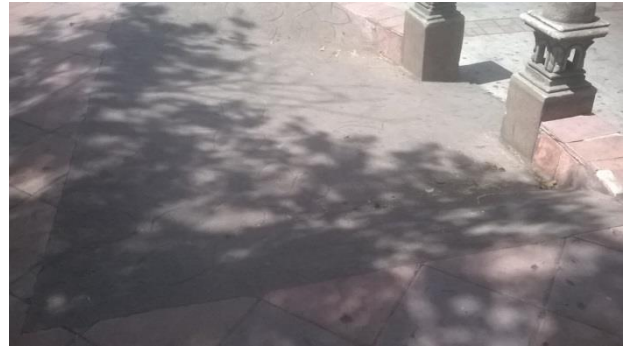
Figura 121 Única rampa de acceso para discapacitados al parque central no cuenta con las condiciones adecuadas para su buen funcionamiento. Fotografía propia (Amatitlán 2015)
