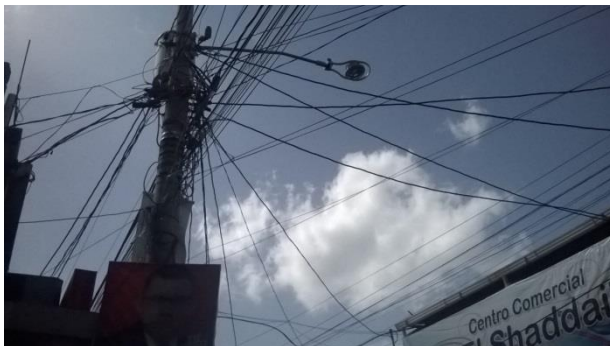
Figura 109 Poste de concreto con luminaria y transformador, se observa también la aglomeración de cables eléctricos, en la 6ª calle de 3ª a 4ª Avenida. Fotografía propia (Amatlán 2015)
