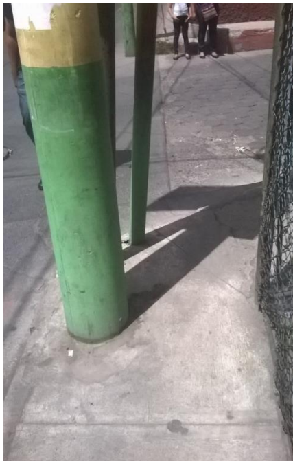
Figura 76 Aglomeración de postes de tendido eléctrica y cable TV, reduciendo más el espacio para la circulación peatonal esquina 2ª avenida y 8ª calle. Fotografía propia (Amatitlán 2015)
