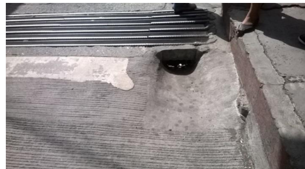
Figura 100 Rejilla de tragante, obsérvese un orificio en un extremo de la misma utilizado como boca de tragante, esquina de la 3ª Avenida de 6ª calle. Fotografía propia (Amatitlán 2015)
