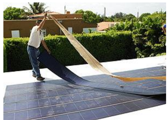
20 Panel Fotovoltaico. Fuente: www.delptavolt.pe
