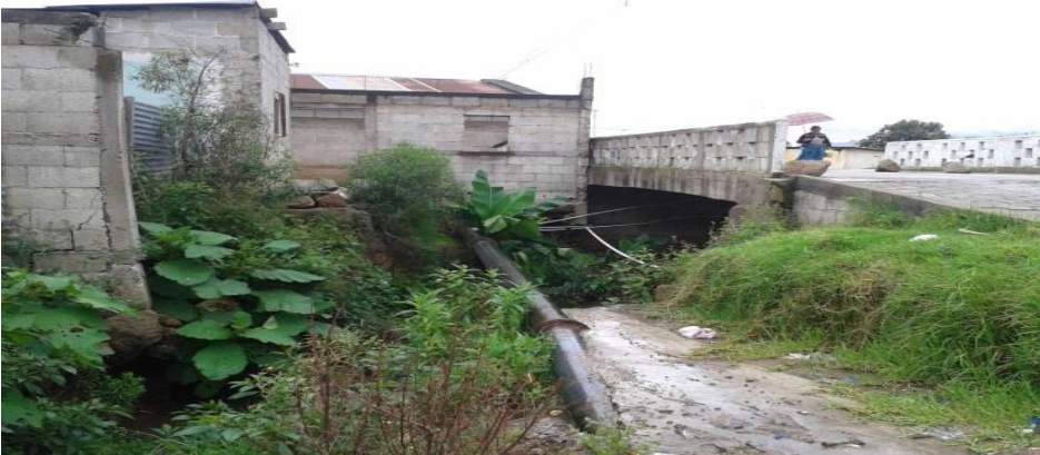
Imagen 6. Vista del río que cambia su cauce y atraviesa la calle del aserradero. Se puede observar la tubería de conducción de agua potable que se ubica bajo una vivienda, asimismo se observan los cimientos expuestos de las viviendas. Fotografía Manuel Montufar
