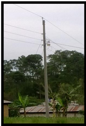
FOTOGRAFÍA POSTES DE ALUMBRADO PÚBLICO 100V. 220V. TRIFASICA
