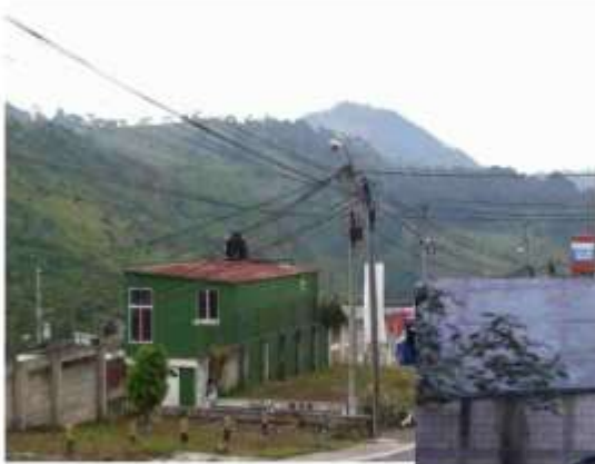
Imagen No. 37 Saturación de cableado Fuente: Trabajo de campo
