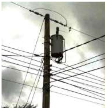
Imagen No. 14 Poste de energía eléctrica en Pinares del Norte
