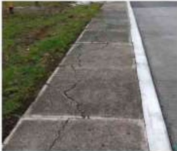
Imagen No. 15 Mal estado de acera peatonal Fuente: Trabajo de campo
