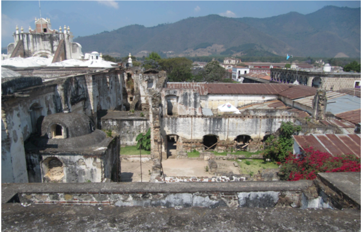
Vista desde el techo de la Capilla de Nuestra Señora del Socorro hacia el área en ruinas.
