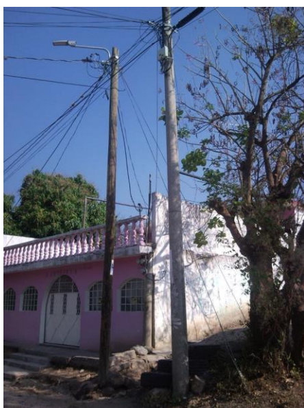
Foto 3: Ubicación de poste de energía eléctrica, la cual es trifásica.
