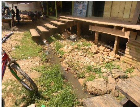
Vista de drenaje expuesto frente a comercios
