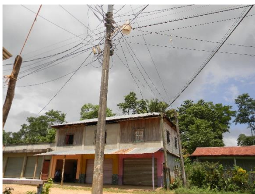
Poste eléctrico en esquina posterior del terreno
