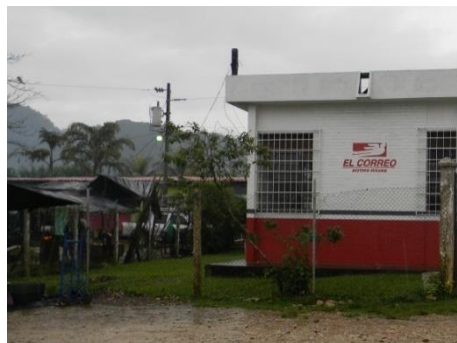
Poste 4 con transformador
