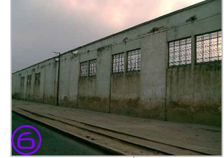
6 IMAGEN DE ELABORACIÓN PROPIA: LAS PAREDES QUE SON RECONOCIDAS COMO PATRIMONIO CULTURAL ESTAN EN COMPLETO DETERIORO DEBIDO AL ABANDONO DEL SITIO.
