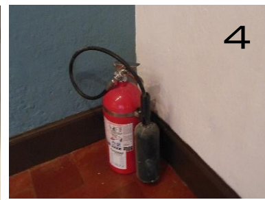
IMAGEN 4 – ELABORACIÓN PROPIA: EN LOS INTERIORES DE LAS SALAS DE EXPOSICIÓN NO ESTAS COLOCADOS A PARED LOS EXTINTORES.
