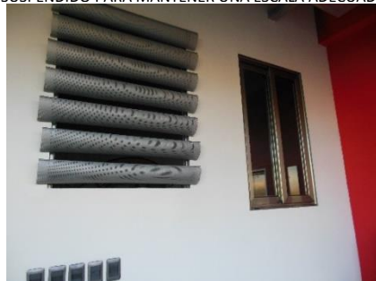
IMAGEN DE ELABORACIÓN PROPIA: COMO EN ESTA IMAGEN SE OBSERVA EL USO DE ELEMENTOS DE PROTECCIÓN SOLAR EN TODAS LAS VENTANAS QUE DAN HACIA LA FACHADA CRÍTICA DE ARTECENTRO.
