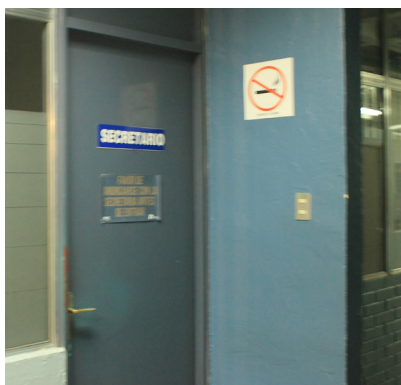
Oficina del secretario académico, en el primer nivel del edificio T2, dentro del área de administración. Rótulo en mala ubicación.
