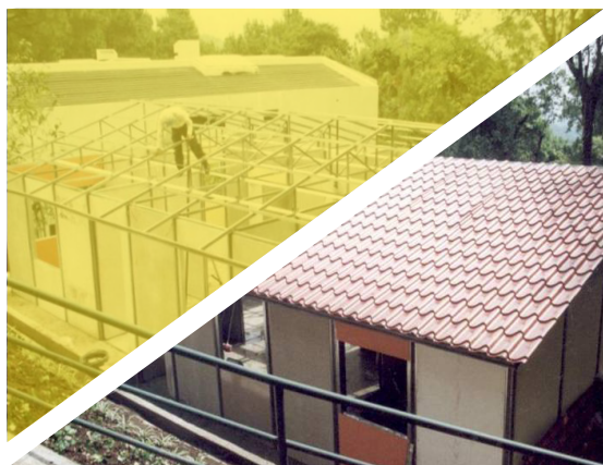
Figura 1 & 2. Inicios y finalización de la construcción de la fundación FUNDAL. (Recuperado de Institución Fundal).
