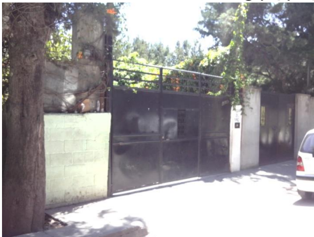
Fachada Principal la cual presenta una fachada rígida sin ninguna composición de diseño FUENTE: Propia
