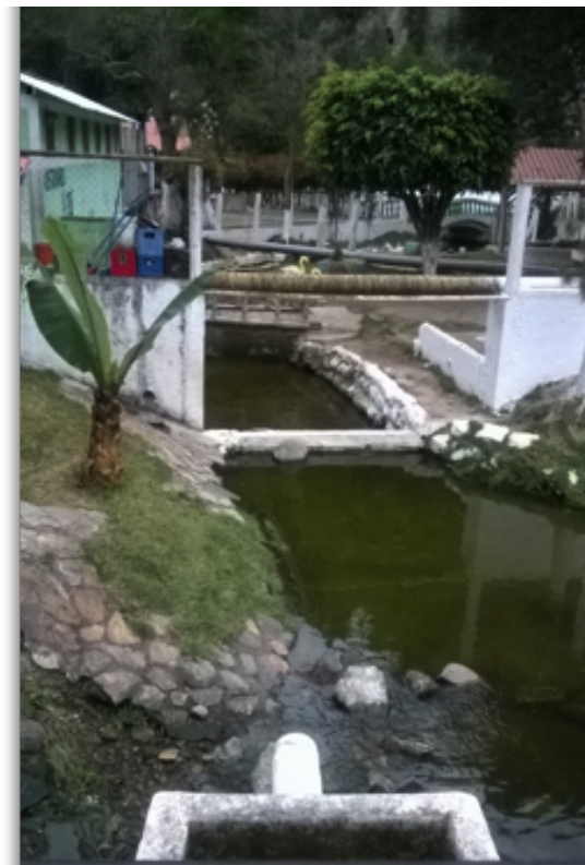
Figura 145 Desfogue de aguas. (Balneario Los Aposentos, Chimaltenango, 2016). Nota: La caja de registro cuenta con una tubería pvc, para desfogue de aguas hacia un riachuelo.
