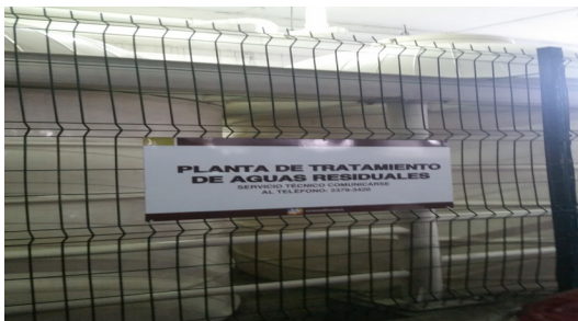
Figura 156 Planta de Tratamiento de aguas residuales. Fotografía de Jaime José Machorro Flores. (Centro comercial Miraflores julio, 2016)
