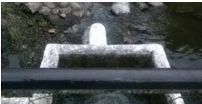
Figura 129 Desfogue de aguas. (Balneario Los Aposentos, Chimaltenango, 2016) Nota: La caja de registro cuenta con una tubería pvc diámetro 4" para desfogue de aguas hacia un riachuelo.
