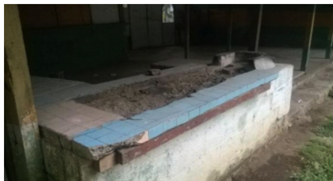
Figura 96 Vista interior de comedor, sin mobiliario y estufa en reparación. (Balneario Los Aposentos, Chimaltenango, 2016)
