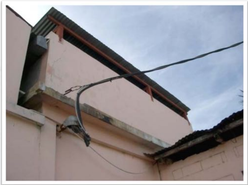
Mala conexión con la Energía Eléctrica y techos colapsados.
