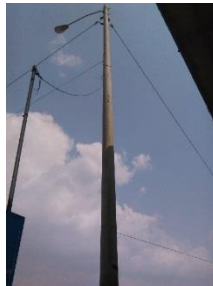
2 Imagen 5.5.2 Poste eléctrico dentro de predio Postes de luz
