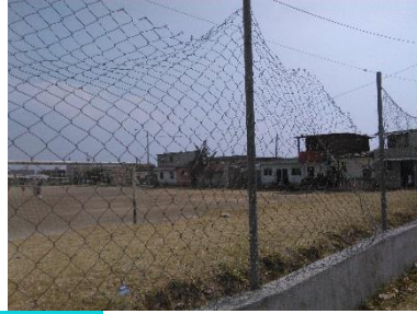
5 Imagen 5.5.5 Estado de muro perimetral Muro perimetral. Necesita mantenimiento.
