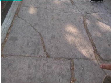
7 Imagen 5.5.7 Estado actual de banquetas colindantes al predio. Estado de banqueta. Circulación peatonal.
