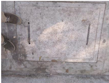
1 Imagen 5.5.1 Acometida de agua. Acometida de agua potable
