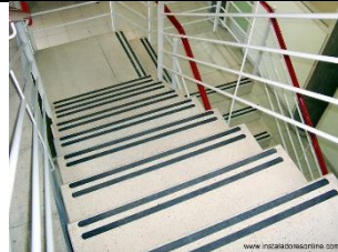
Imagen 6.2.16 Antideslizante en gradas. imagen recuperada 18/05/2015 de http://www.instaladoresonline.com/galerias/galeria_feludos/safety_walk/antideslizantes_escaleras1big.jpg
