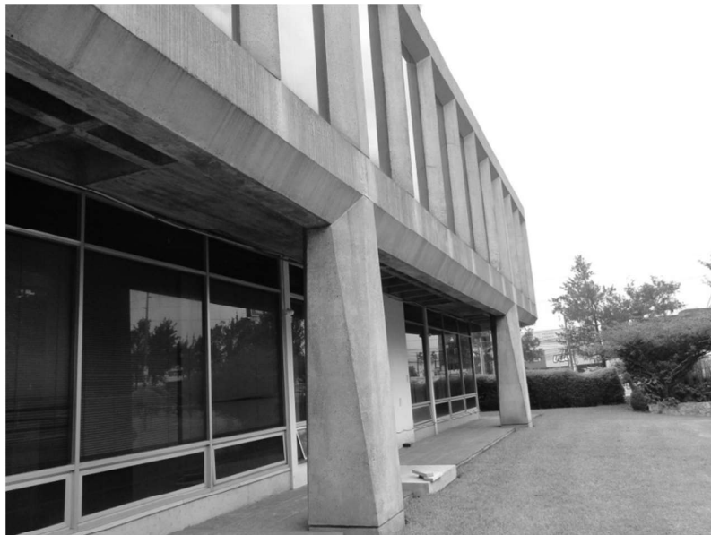
Figura 237. Columna tipo A en edificio administrativo, Laboratorios Abbott. (Actual Agencias J. I. Cohen).
