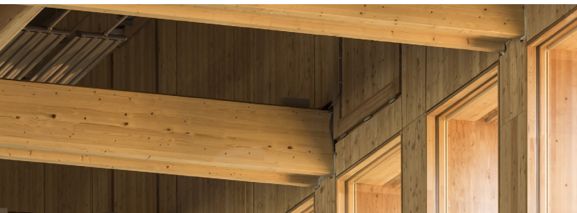
FOTOGRAFÍA NO. 31 - Análisis Estructural, Fuente Plataforma Arquitectura.
