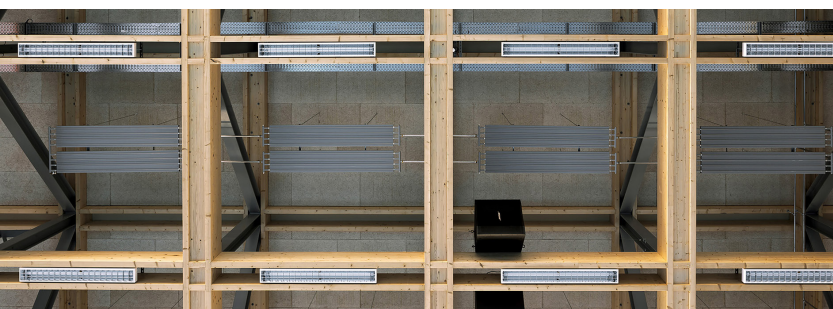
FOTOGRAFÍA NO. 32 - Análisis Estructural, Fuente Plataforma Arquitectura.
